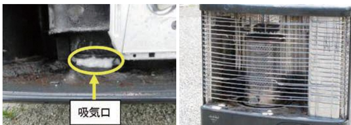
写真13 吸気口の日詰まり状況
