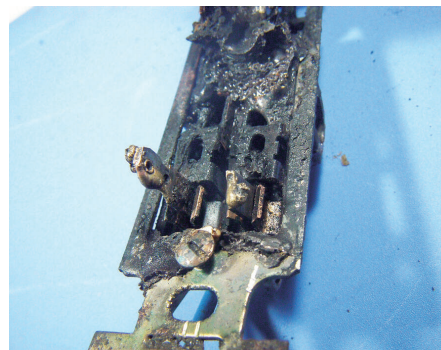
写真3 溶断した差込刃が残ったコンセント
