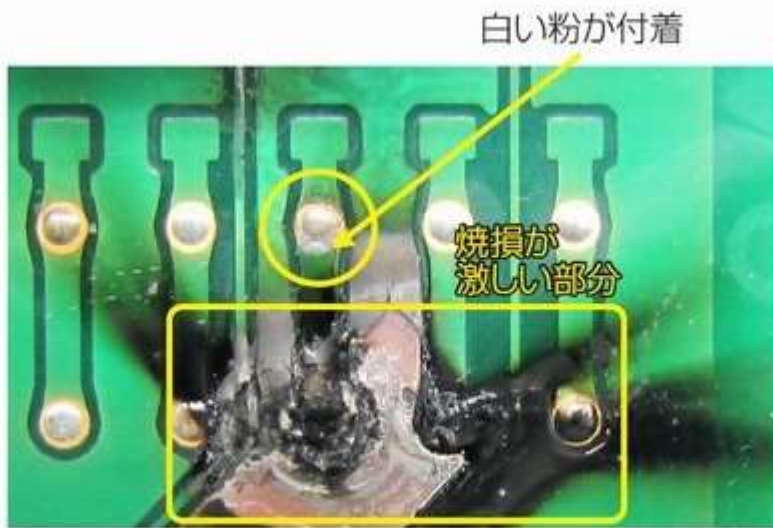
図1 焼損した基板の部品実装面
